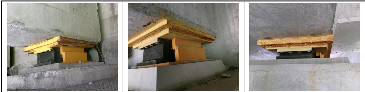
① 교량받침 플레이트 부식, 도장박리(도장손상부) - 진전 여부, 2차 손상 발생여부 확인
